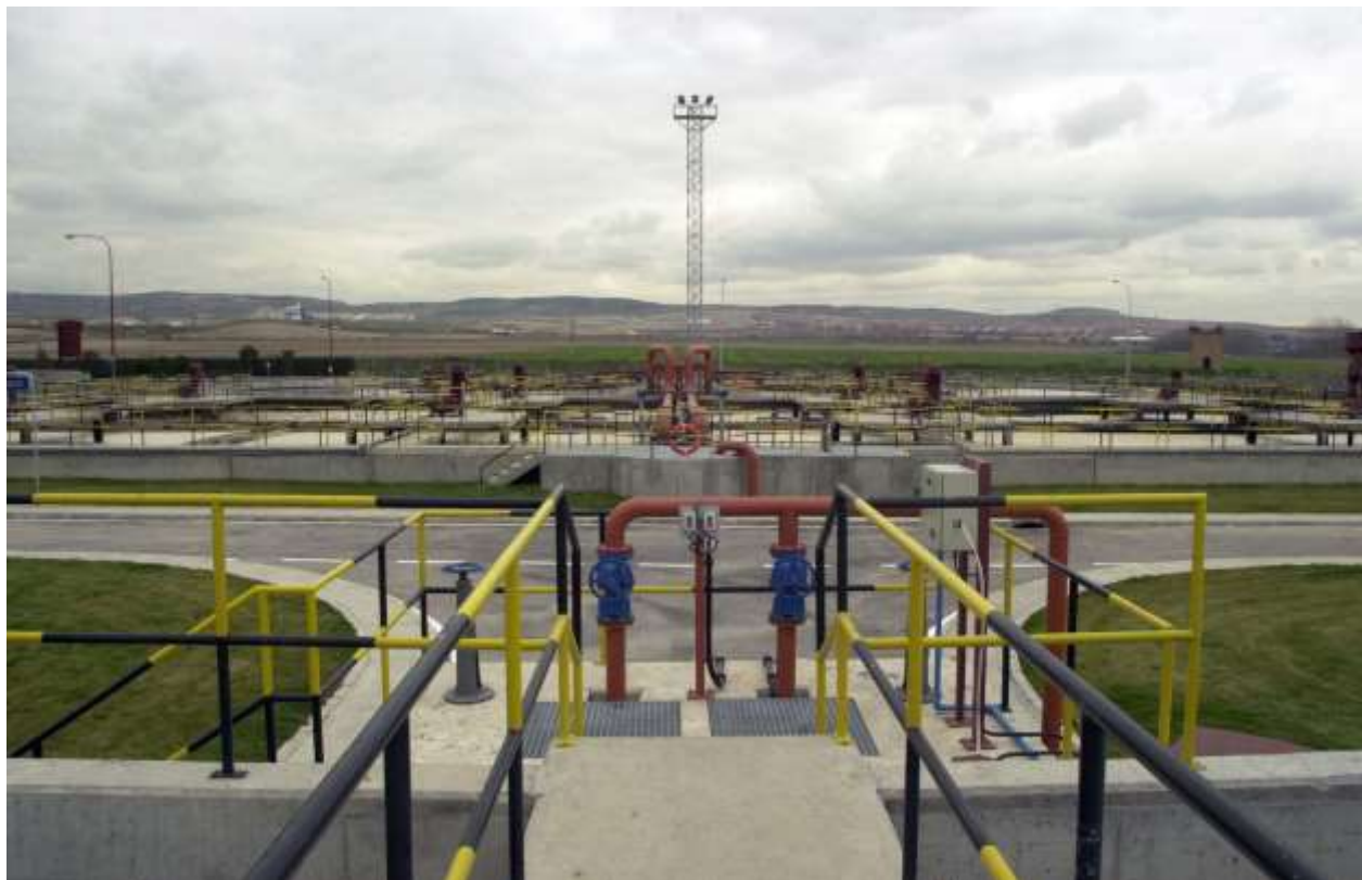
Vista general de la EDAR Sur, propiedad del Ayuntamiento de Madrid y gestionada por el Canal de Isabel II, a través de Cadagua
