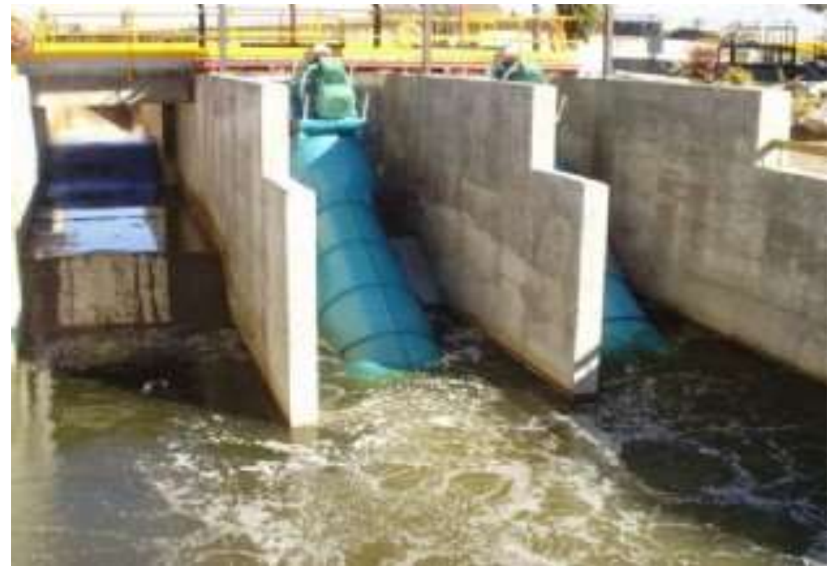
Turbinado de la EDAR SUR
